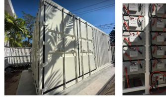
รูปที่ 4 ระบบกักเก็บพลังงานแบตเตอรี่ ขนาด 100kW/200kWh
